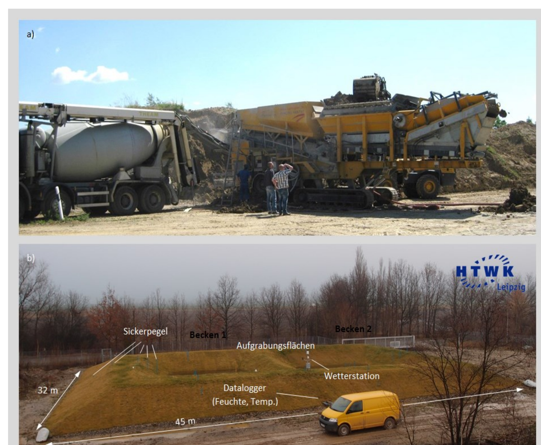
Abbildung 3: a) Freilandversuch zur Herstellung von CLSM, b) Forschungsdeich der HTWK Leipzig mit eingebauten CLSM-Dichtungen
