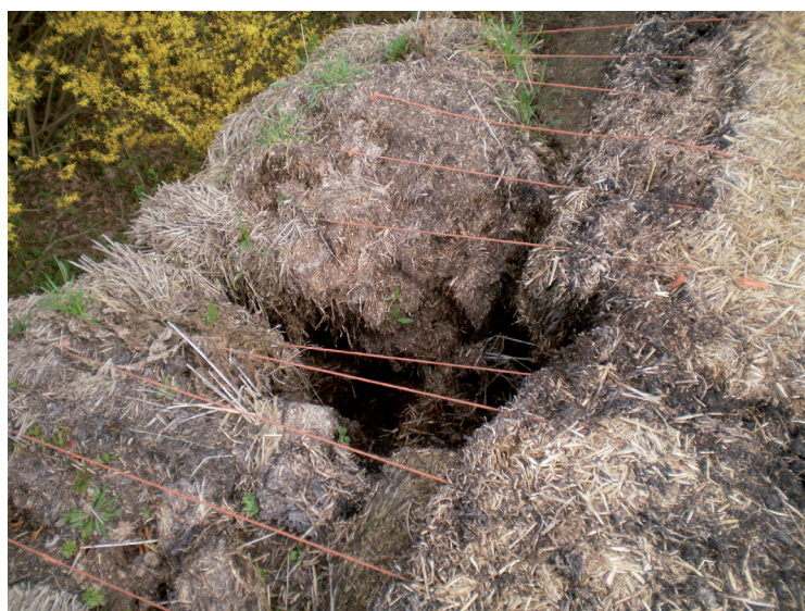
Ungeschützte Wandkrone: stark verrottete Bereiche
